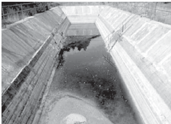
Obr. 1. Retenční nádrž kumulující AMD [3].
